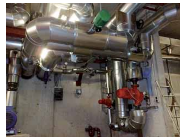
Installation im Heizwerk für Geothermieanbindung
